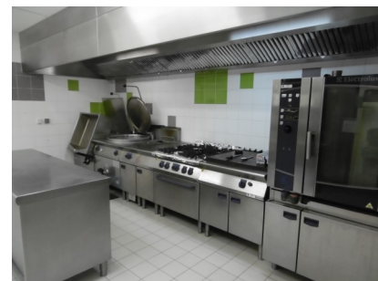
Cuisine du restaurant scolaire
